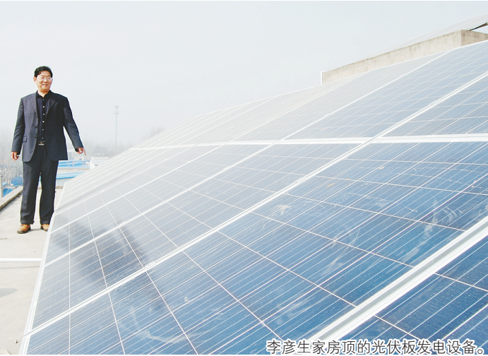
李彦生家房顶的光伏板发电设备。
