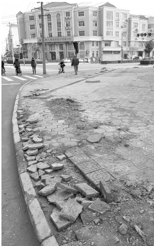
破损地砖。见习记者 王麓棣 摄
