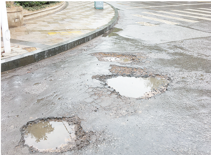
路面坑洼之处积满了水。
