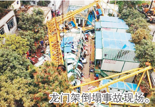
龙门架倒塌事故现场。
