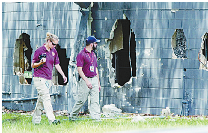
当地时间6月12日,在美国佛罗里达州奥兰多市,遭袭夜店的西侧外墙已千疮百孔,调查人员正在取证。
