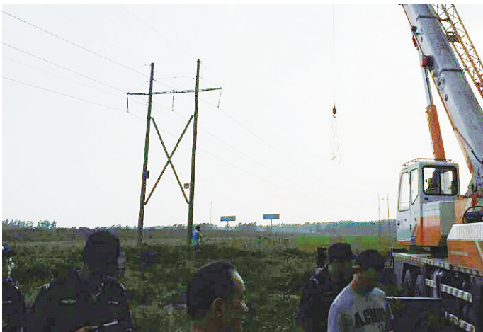
受损的高压线。 本报记者 张晓甫 摄
