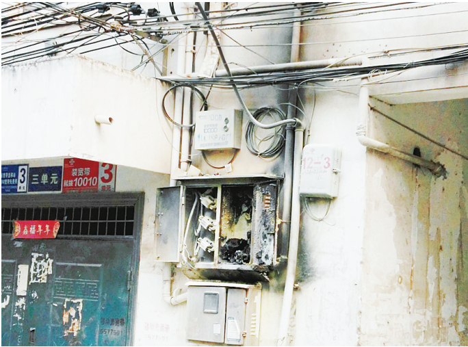
被烧毁的电表箱。
