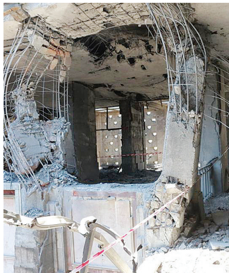
当地时间7月16日，在土耳其安卡拉，议会大楼在政变中被损毁。
