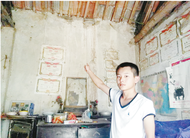
“等挣到钱了，就和爸爸把屋顶的洞修补一下。”张洋说。
