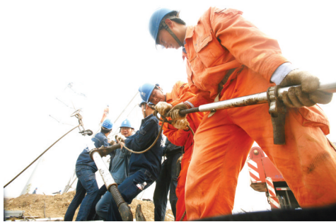
加快电网建设,助力地方经济社会发展
