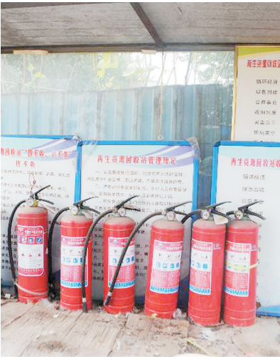
整治后,再生资源回收点摆放着消防器材。
