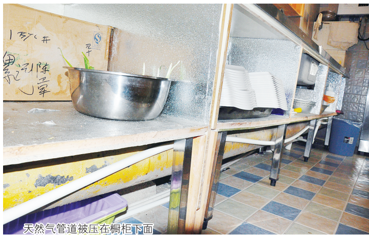
天然气管道被压在橱柜下面
