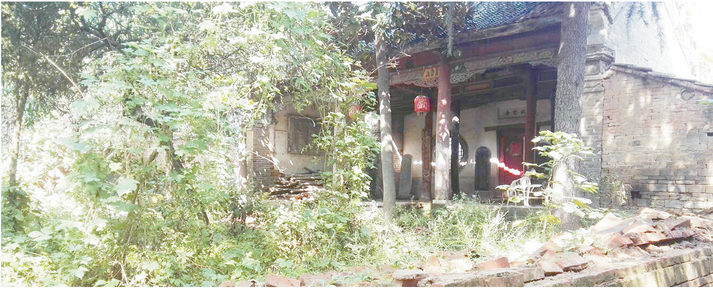
▲张氏祠堂东面的围墙已经倒塌，亟待修缮。
