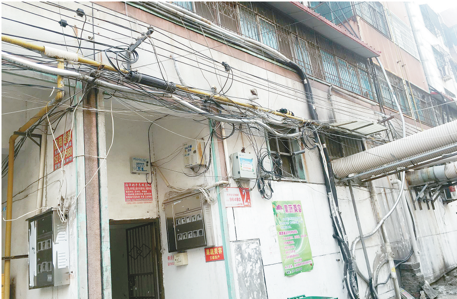
海河路51号院内线缆杂乱无序。
