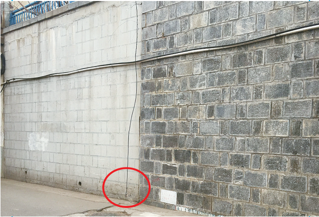
昨天,在市区滨河路涵洞东侧,一根约3米的电缆线下垂到路面。附近居民觉得有安全隐患,希望相关部门尽快处理。 本报记者 王麓棣 摄
