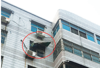
在市区泰山路一栋居民楼上，一个防雨罩摇摇欲坠，十分危险。
