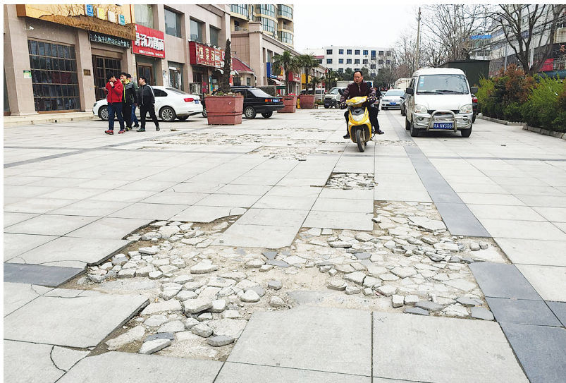
市区棕桐城小区南门两侧门面房门前，路面破损严重。
