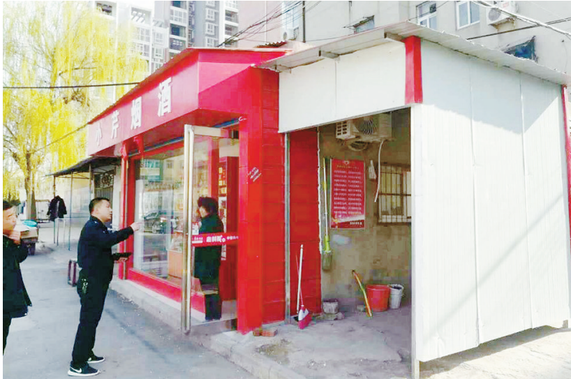
城管队员要求拆除违规搭建的板房。
