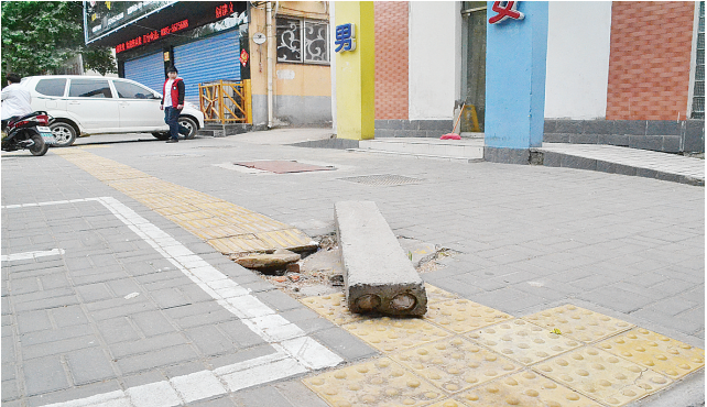
一条水泥板压在盲道上。
