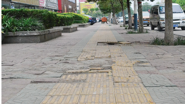
被损毁的盲道。
