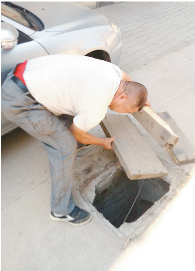
一个窨井盖完全破碎，附近居民用木板盖住窨井。 本报记者 潘丽亚 摄
