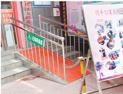
无障碍通道入口被锁上。
