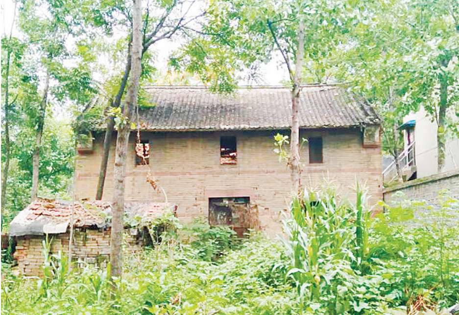
▲简城村一处青砖黛瓦的古宅。村内像这样的古宅有不少，但大多数损毁严重。
