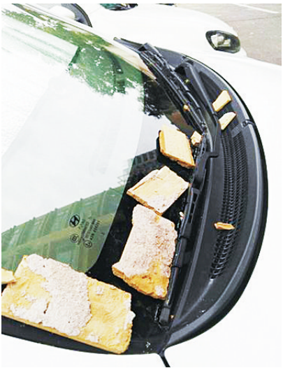
外墙脱落的瓷砖落在汽车上。
