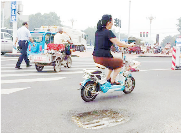
嵩山路与黄河路交叉口西北角，一个排水井盖凹陷。 本报记者 张玲玲 摄
