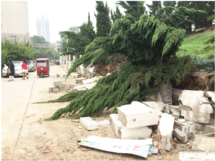
小区围墙倒塌，墙体砖块散落在地上。
