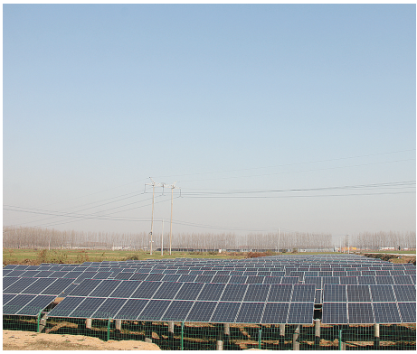
建成的光伏发电项目。
