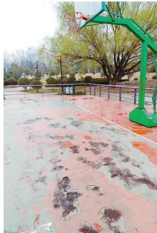
篮球场破损的塑胶地面。
