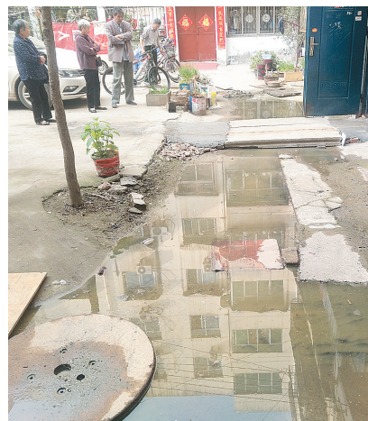
楼栋前的积水。
