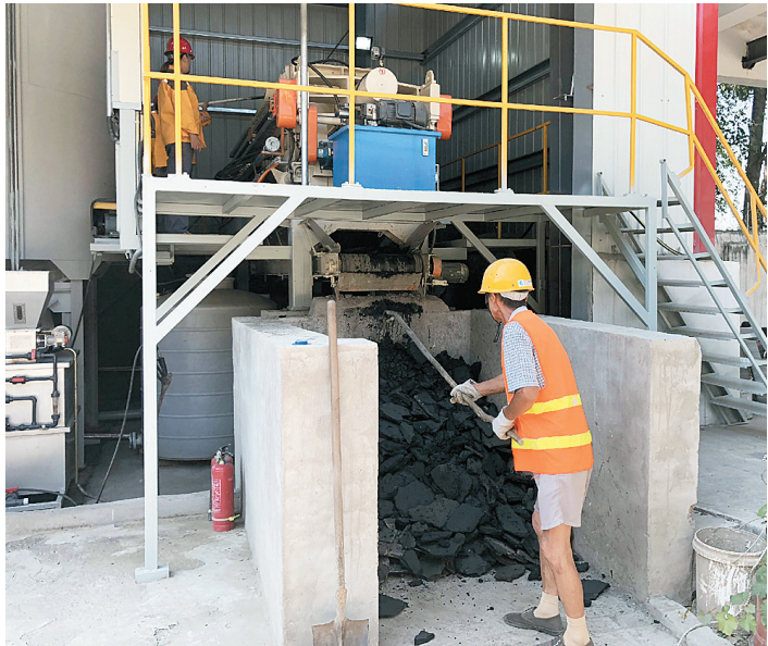
工人在污泥处理装置前忙碌。
