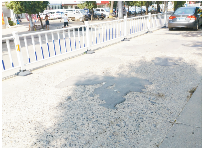
路面沥青脱落，不少石子裸露。
