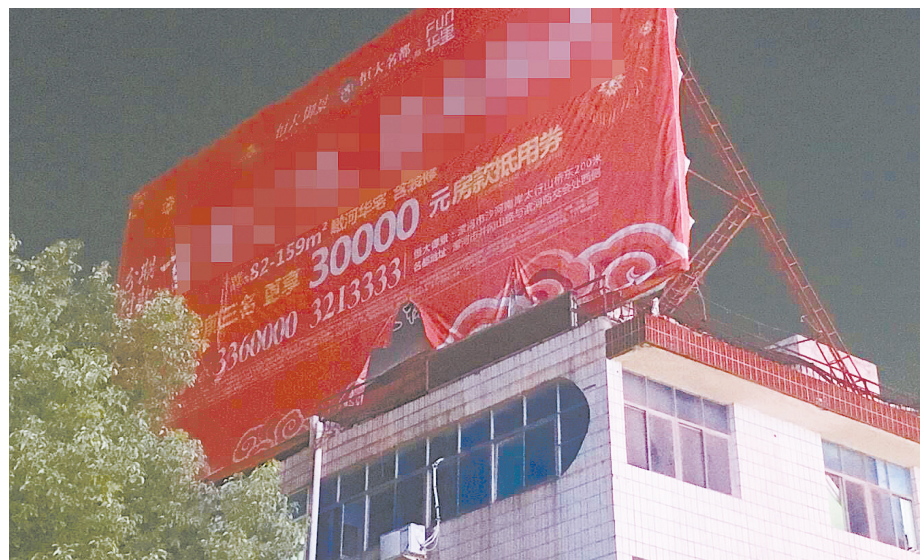
在市区黄河广场一角，一处户外广告画面已破损。
