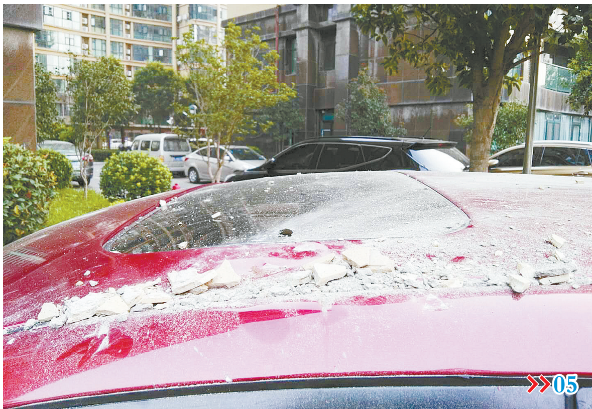
进入8月,我市遭遇了几场大风大雨天气,几个小区的居民外墙瓷砖脱落,虽然没有发生砸伤人的事,但一些车辆还是遭了殃。图为8月23日晚,停放在市区黄山路一小区楼下的一辆轿车,被脱落下来的瓷砖砸伤。 本报记者 王辉 摄
