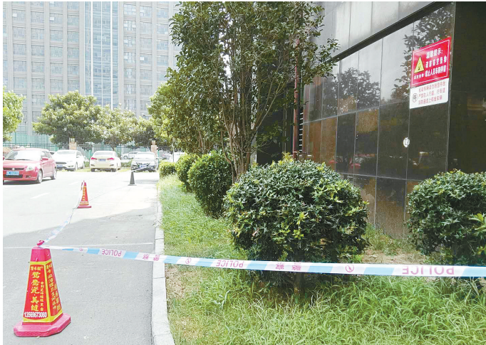
黄山路一小区，外墙瓷砖脱落的区域已经拉上警戒线，并张贴了提醒标识。
