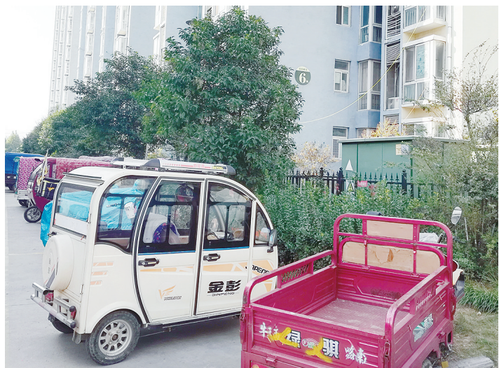
从楼上垂下来的电线，正在给楼下的电动车充电。
