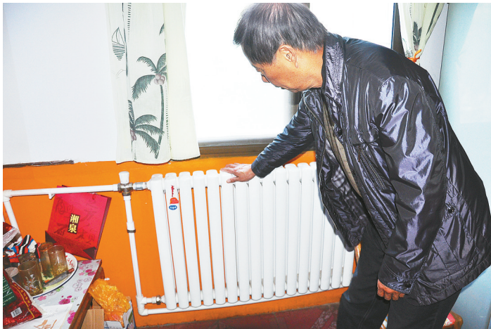
烟厂花园一居民家中开始供热。
