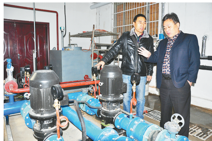
漯河小学负责人和供热工作人员检查设备运行情况。
