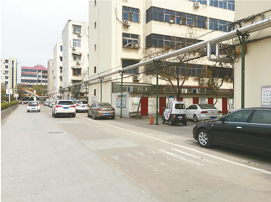
烟厂生活区,供热管道通进各户居民家中。
