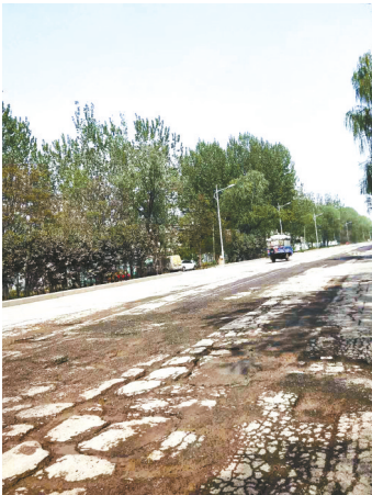
路面破损严重。
