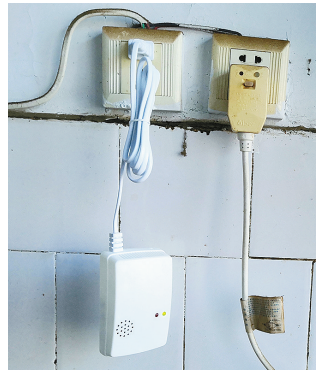
小伙安装的燃气检测器。
