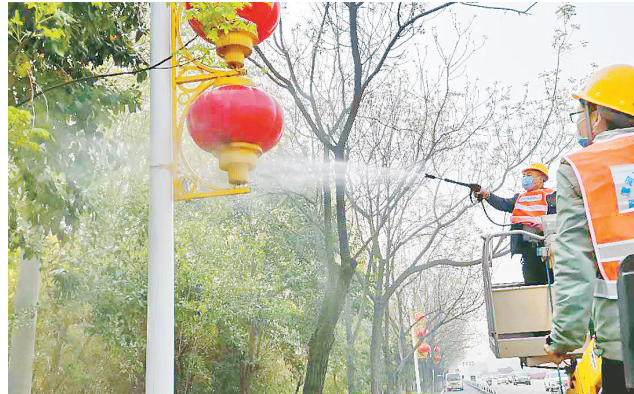
连日来，市城市管理局路灯维护中心用水枪对金山大道(淞江路至高速路口)810盏灯笼灯进行全面冲洗。
