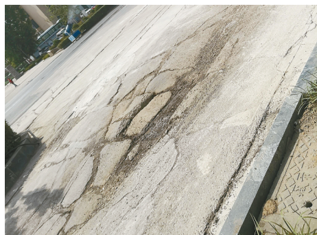
市区中山路银鸽厂门前路面破损严重。
