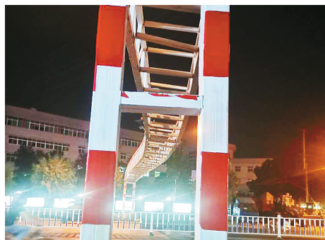
辽河路与白云山路交叉口，限高杆扭曲变形。
