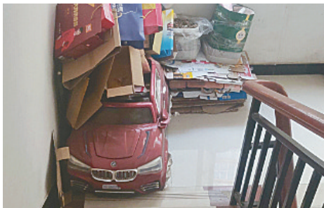
长江路泰盈紫金城小区3号楼一单元4楼安全通道长期被一住户堆放大量废品。
