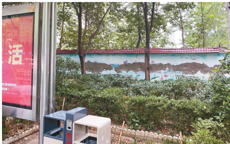
嵩山路丹尼斯北，一单位围墙墙面大面积损坏。
