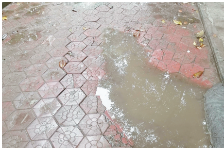
银鸽新苑小区11号楼和12号楼之间的路面严重损坏。
