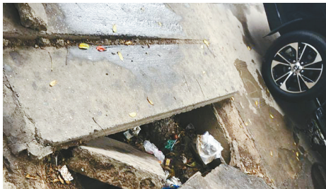
海河路川渝香辣蟹门口的大坑存在安全隐患。
