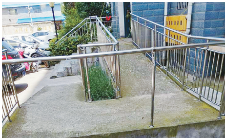
泰山路北段盛世浩苑小区无障碍通道防护栏杆被人破坏。
