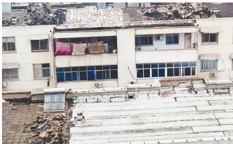
市第三人民医院家属院顶楼有废弃物堆积,刮风天扬尘污染环境。
