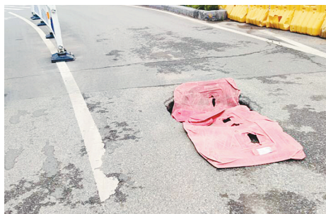
湘江路与金山路交叉口东南角拐弯处，窞井盖缺失，没有警示标志。
