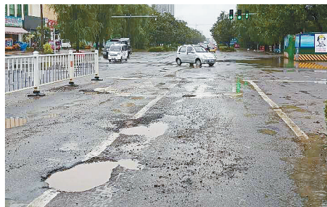
金江路与文化路交叉口路面损坏严重。
