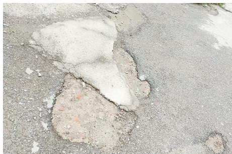
燕山路新空间小区路面坑坑洼洼。
