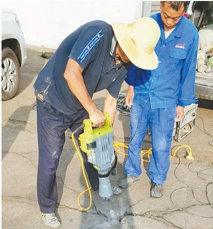
6月29日,市政建设和公用服务中心巡查人员发现黄河路与解放路交叉口路面下疑似有空洞,立即组织人员查验并修复。 本报记者 朱红 摄
