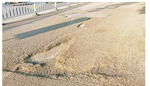
嵩山路与黄河路交叉口东北角道路坑洼不平。
