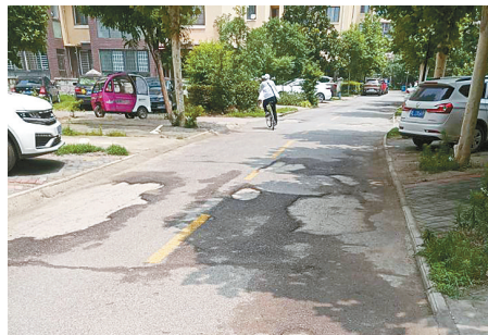
天鹅湖小区道路破损严重。
