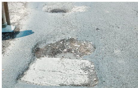
泰山路与银江路交叉口,路面破损严重。
