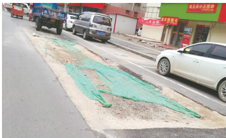
市区文化路中段，施工后路面没有及时修复、没有设置提示牌。
