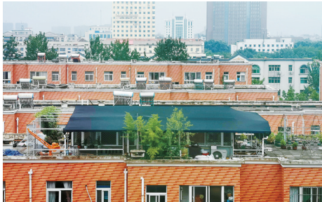
市区辽河路通和馨居小区东侧第四栋二单元楼顶私搭乱建。
